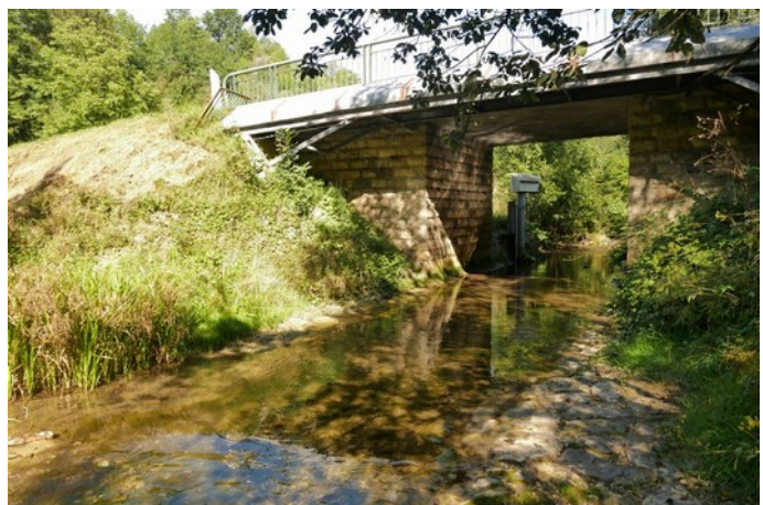
Illustration 28: Station hydrométrique des Éparis, septembre 2019
